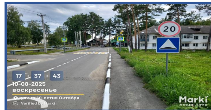
Установка ограничивающих металлических пешеходных ограждений в п. Кедровое Месторасположение объекта: п. Кедровое, ул. Школьников, ул. Классона
